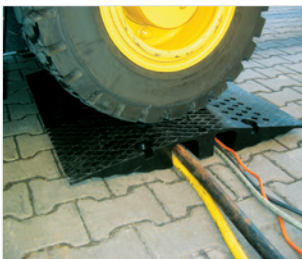
3) Schlauchbrücke gedreht als Kabelbrücke
